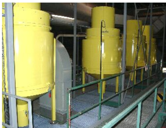
Zyklonfiltersystem als Nachfilter in der Pulverbeschichtung
