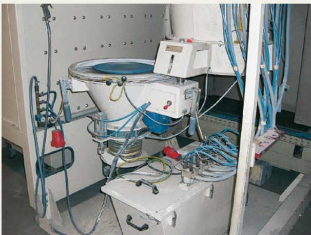
Vorher: Kettler, Hersteller von Gartenmöbeln und Sportgeräten, nutzte ein Vibrationssieb mit Drehklappe und Fluidbehälter
